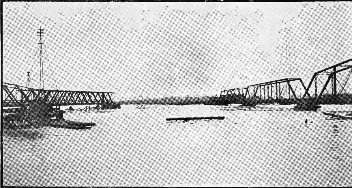
Die Zerstörung der unteren Wagenbrücke durch die Hochfluth am 4. April 1904.
